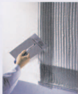
4 Das Sto-Abschirmgewebe AES wird wie ein herkömmliches Glasfasergewebe verarbeitet, muss aber zusätzlich geerdet werden. (Fotos 1, 3, 4: Sto)
