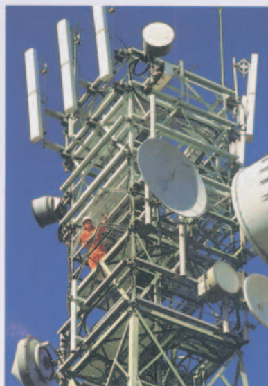
1 Wenig beliebt: Sendeanlagen für den Mobilfunk. Aber das Handy ist nur ein Verursacher von Elektrosmog.
